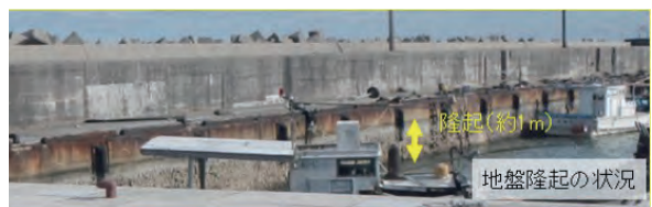
狼煙漁港(上)、地盤隆起の状況(下)
