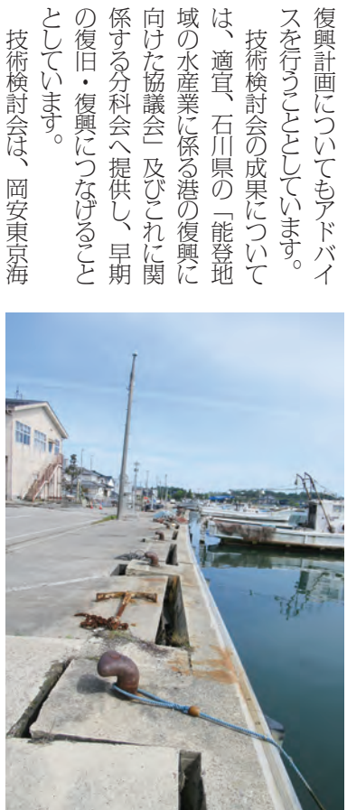
施設の傾斜・沈下 (石崎漁港)
