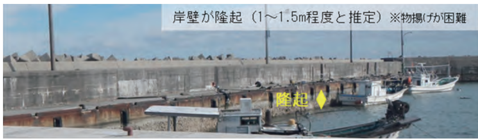
-3.0m 岸壁隆起状況
