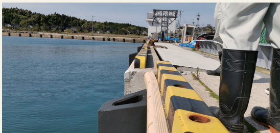
蛸島漁港の被害状況
